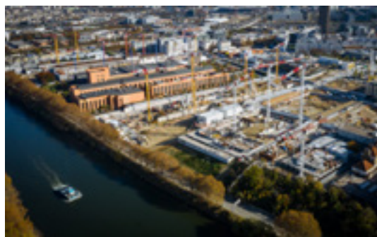
39 grues devaient être en action en février sur le chantier du Village olympique.
